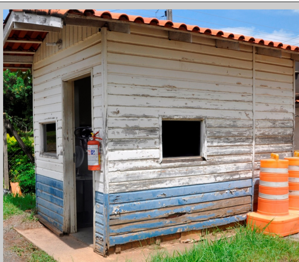
BASE DA GM: O STMC vem denunciando desde 2010 para a imprensa e sociedade que algumas Bases da GM são de madeiras e, portanto, estão deteriorando por falta de manutenção. As condições são insalubres e alguns banheiros não funcionam.
